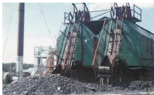
2010 г. Котельная ОАО «Теплоэнергия» по ул. 40 лет Октября.
